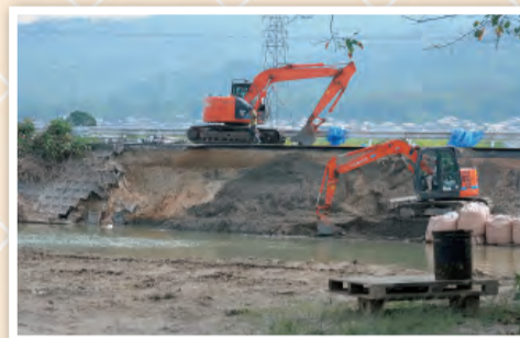
大雨で護岸が崩れ、道路の下までえぐられた大戸川（2013年9月）
